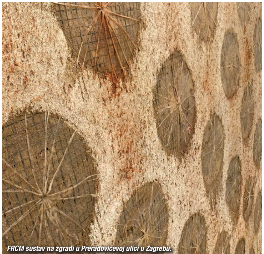
FRG sustav na zgradi u Preradovićevoj ulici u Zagrebu.
